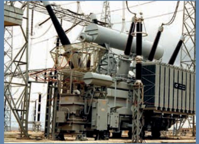
ترانسفورماتور قدرت 200 MVA – 400 / 230 / 20KV
