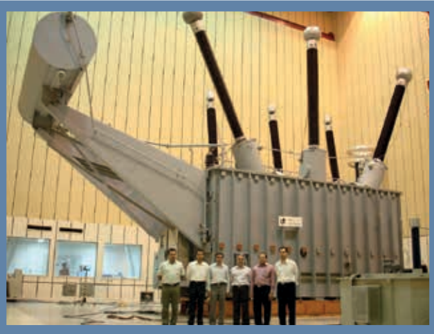
ترانسفورماتور قدرت ( فارس ) 315 MVA – 400 / 230 / 20 KV
