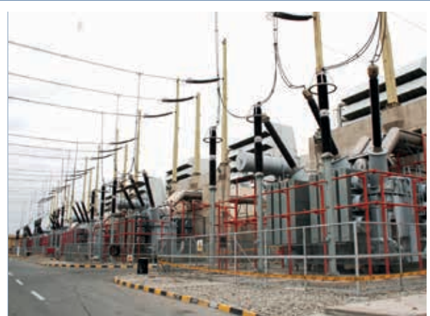
نیروگاه دماوند 200 MVA – 15.7 / 420 KV
