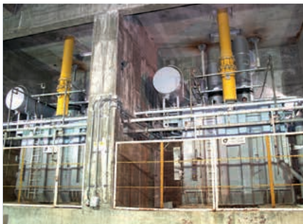
نیروگاه برق آبی کارون 100MVA – 15.7 / 420 KV
