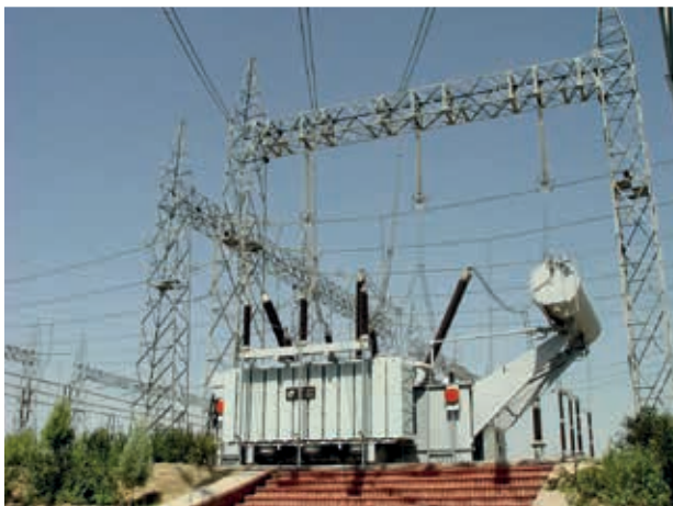
پست توس 200 MVA – 400 / 230 / 20 KV
