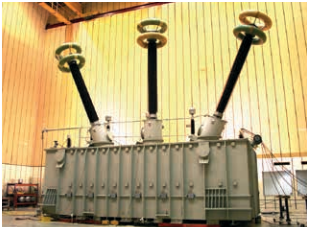
ترانسفورماتور قدرت ( نیریز ) 200 MVA – 400 / 66 / 20 KV
